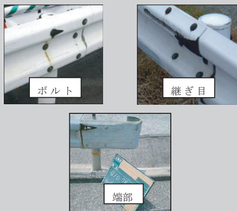
写真-1 防護柵に付着していた金属片
